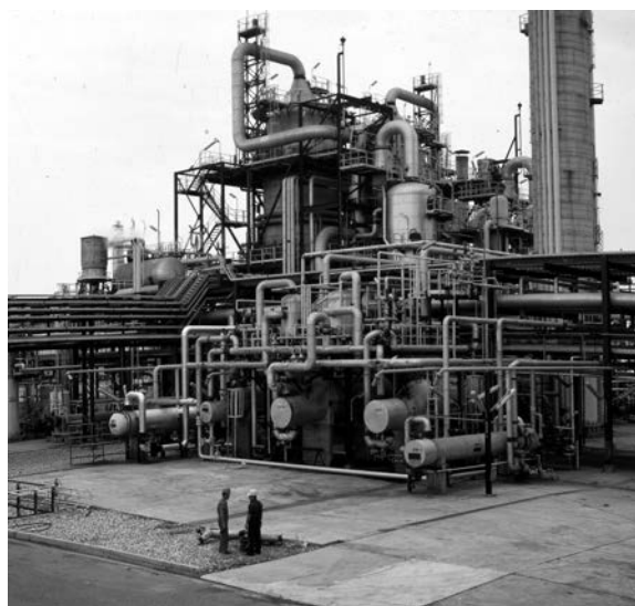
Impianto etilene. (foto Archivio Storico Eni Roma)
