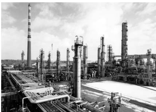
Impianti di una raffineria petrolifera. (foto Archivio Storico Eni Roma)
